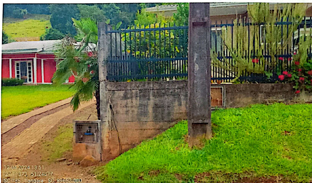
Figura 8. Hidrômetros dos lotes 05 e 06.
