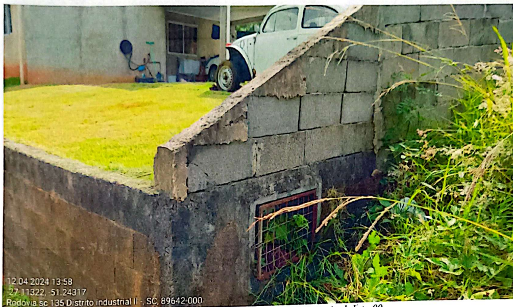
Figura 13. Abrigo para ligação de água potável, lote 09.
