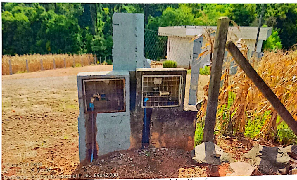
Figura 15. Hidrômetro do lote 11.
