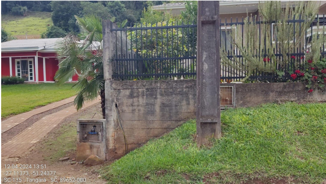
Figura 7. Hidrômetros dos lotes 05 e 06.
