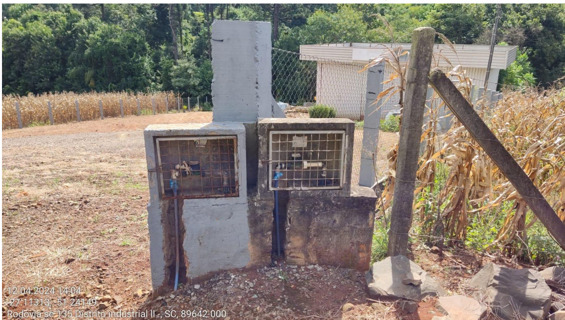
Figura 14. Hidrômetro do lote 11.
