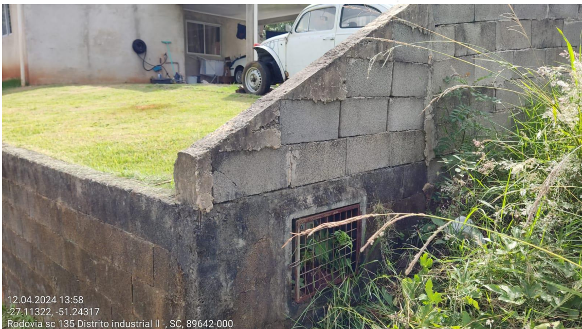
Figura 12. Abrigo para ligação de água potável, lote 09.
